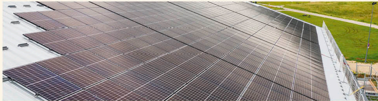
Centrale villageoise sur le toit du gymnase de Morbier ©S.Godin
